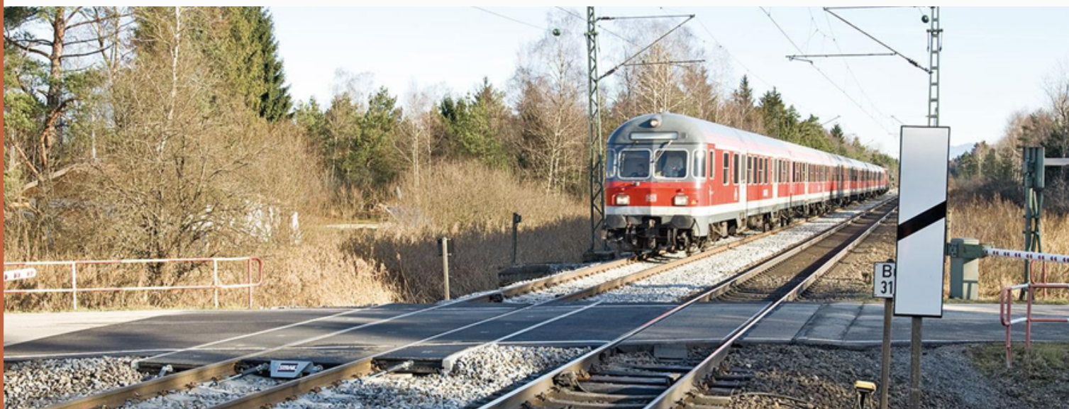
Εικόνα 1. Ισόπεδη Διάβαση με ελαστικό τάπητα τύπου STRAIL
